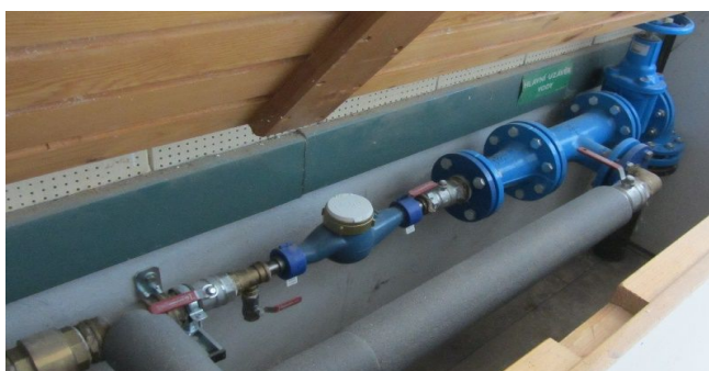
Nový hlavní uzávěr vody
